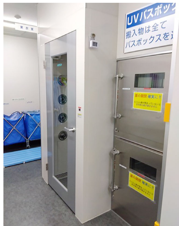
写真5-2 UVパスボックスとエアシャワー
