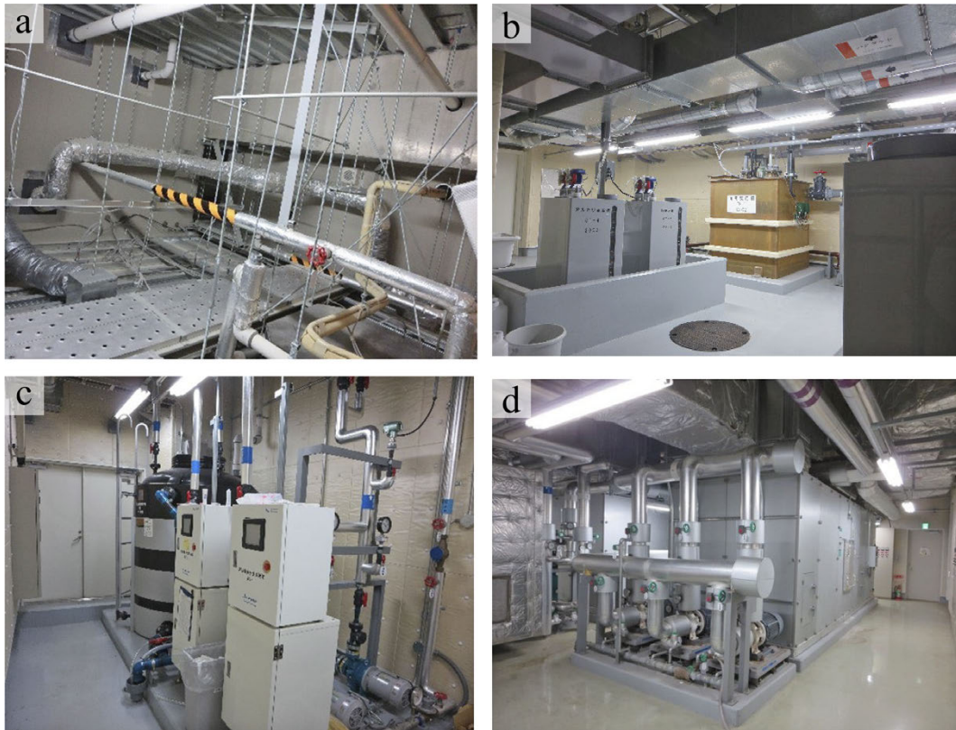
写真3 a) ISS : Interstitial Space, b) 排水処理施設, c) 次亜塩素酸水製造装置, d) 露点浴方式空調機
