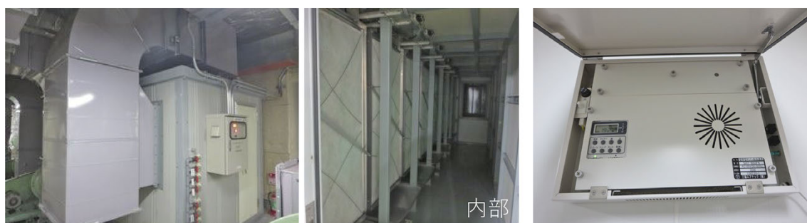
写真2 左・中央：光触媒脱臭装置、右：オゾン脱臭装置
