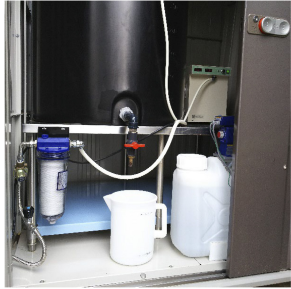
図4 アクアチッド（衛生管理設備）
